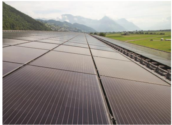
Illustr. 2: L'installation solaire d'une puissance de 1,05 MW, soigneusement montée sur la toiture légèrement cintrée de la halle industrielle, produit chaque année 1,09 GWh de courant sans CO 2 .
