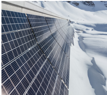
2 Die am Pumpspeicherkraftwerk integrierte PV-Anlage kann bis zu 3 GWh/a emissionsfreien Solarstrom produzieren; davon 44% Winterstrom.
