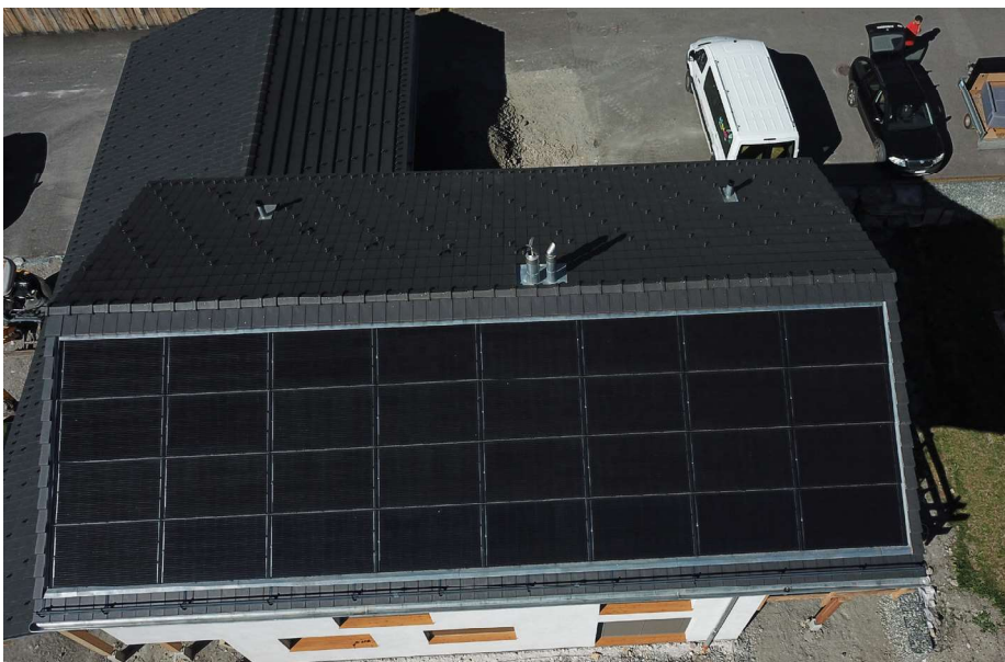
1 L'installation PV génère 9'800 kWh/a, ce qui assure au bâtiment une autoproduction de 285%.
