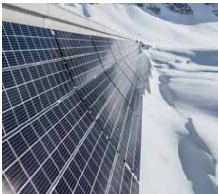
2 Die am Pumpspeicherkraftwerk integrierte PV-Anlage kann bis zu 3 GWh/a emissionsfreien Solarstrom produzieren; davon 44% Winterstrom.
