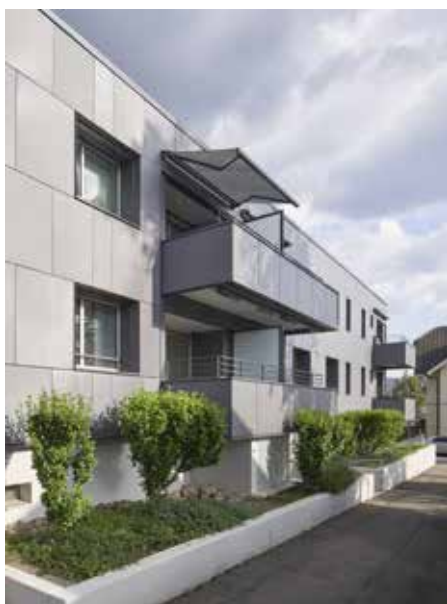
1 Die neu erstellte Fassade mit den integrierten PV-Modulen produziert ca. 14'000 kWh/a.
