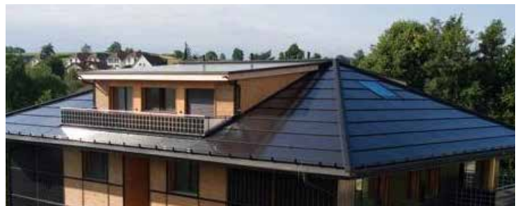
Abb. 1c: Min.P gedämmtes PV-Dach mit ganzflächig vorbildlich integrierter Solaranlage, um mehr CO 2 -freien Winterstrom zu generieren.
