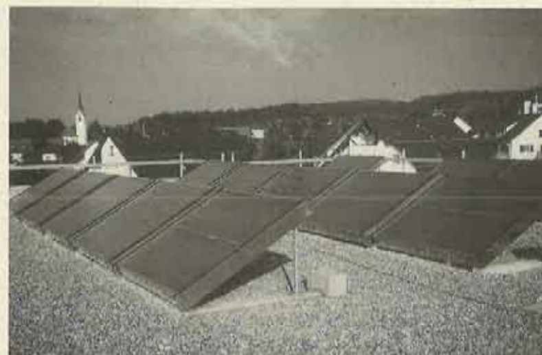
Solaranlage auf dem Flachdach des Altersheim Breitlen
