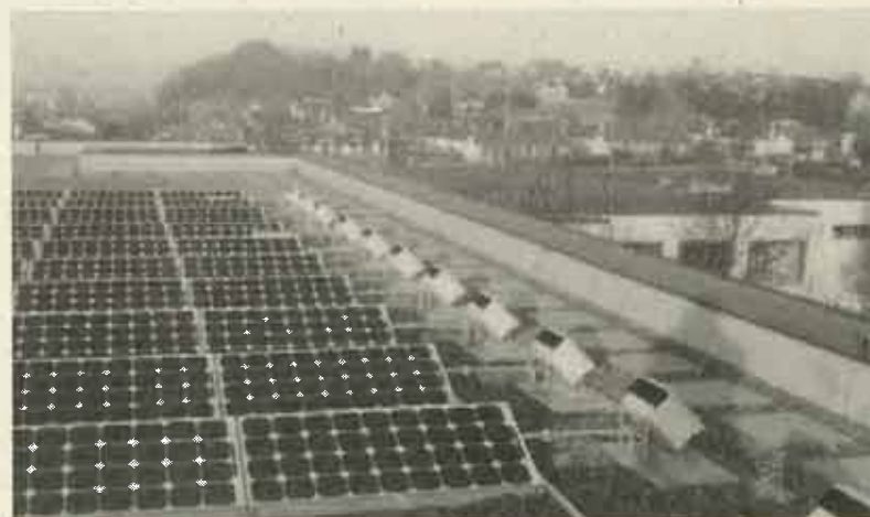
Schulhausanlage «Hintere Matten»: Photovoltaikanlage mit 34,4 kW Leistung.
