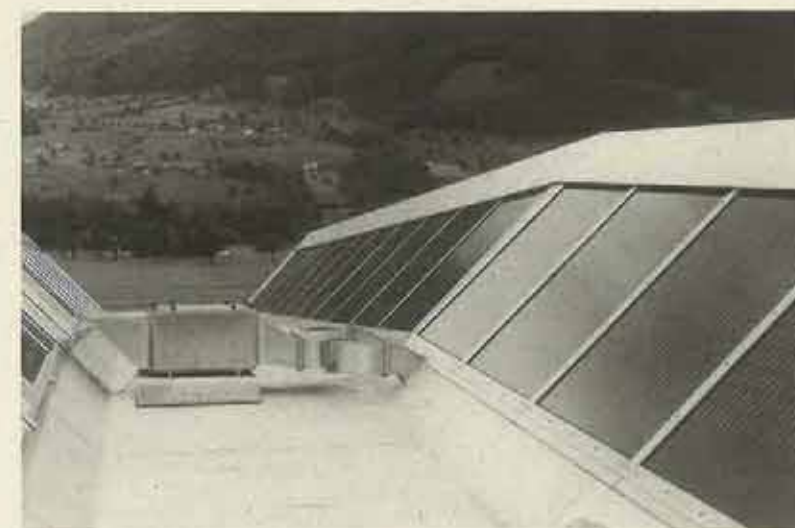
Flughafen Alpnach: Shed mit Solarmodulen und Aussenluftfassung für die Hinterlüftung Photo: Schweizer Luftwaffe
