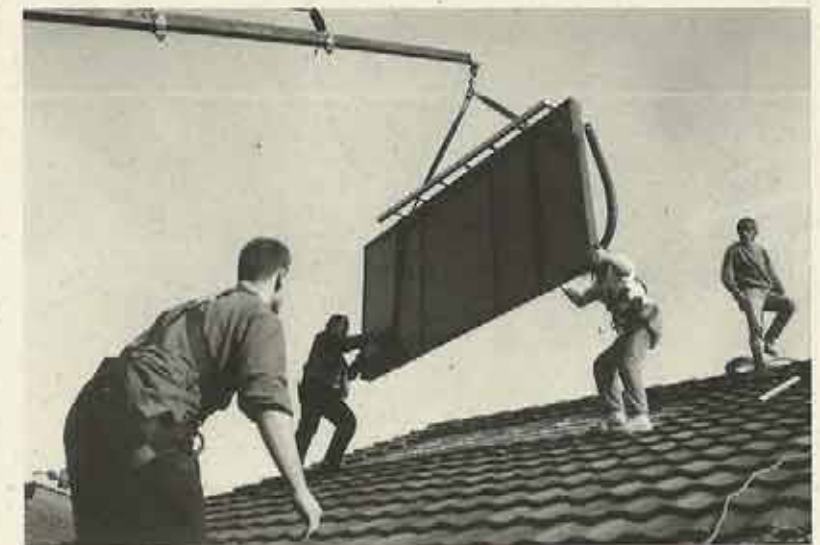
Die SOLKIT ® -Solaranlage kostet fixfertig Fr. 9800.- und wird innerhalb eines einzigen Arbeitstages installiert.
