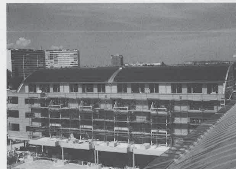
La Cité solaire de Plan-les-Ouates. La toiture solaire de type «AS» assume l'étanchéité et la ventilation d'une toiture normale. Elle a une épaisseur de 2,5 cm, est non-vitrée et produit 300 kWh/m 2 /a.
