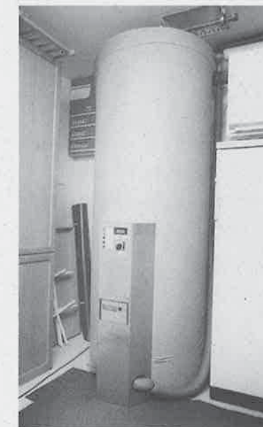
«SOLKIT®» Thermische Solaranlage zur Brauchwassererwärmung im Einfamilienhaus
