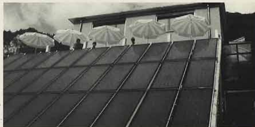
Die Sonnenkollektoren des Centro ecologico uomonatura
