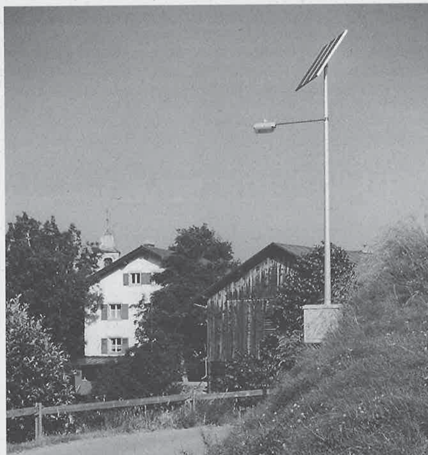
Solarstrassenlampen der Gemeinde: Photovoltaische Installation; Inbetriebnahme im November 1992; Absorberfläche der Kollektoren: 4 m 2 ; Installierte Leistung: je 0,15 kW; Beteiligte Firma/beteiligter Architekt: René Brun, Alternative Techniken, 7015 Tamins, Tel. 081/37 25 37, Fax 081/37 23 74
