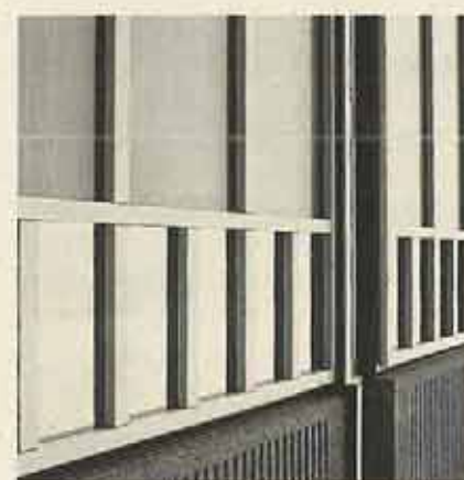
Die Solarpaneele sind im Bereich des Treppenhauses vollständig in den mittleren Teil der Fassade integriert. Hier ist die Metallfassade durch Pfosten in fünf vertikale Bahnen gegliedert. Zwei Bahnen sind mit Sonnenkollektor-Paneele und die übrigen mit Sonnen- und Wärmeschutzgläsern resp. Isolationspaneelen bestückt.
