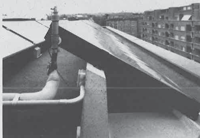
Immeuble locatif, 34, rue de l'Avenir. 21 m 2 de capteurs solaires, placés en toiture, 1988.
